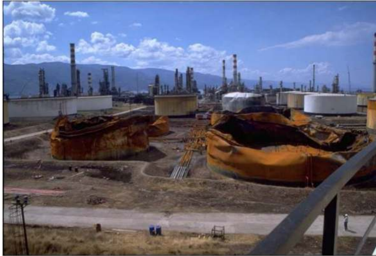
Şekil 3. Tüpraş rafinerisinde meydana gelen yangın hasarı(Erdik, 2000)
