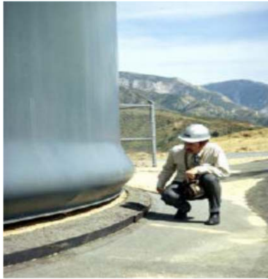
Şekil 1. Fil ayağı burkulması
